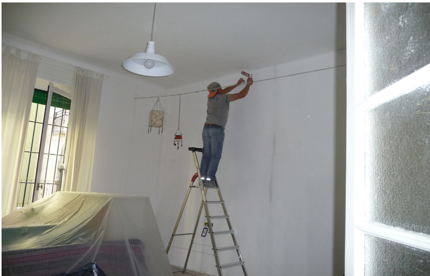
FASE 7 - Finitura delle pareti con almeno tre mani di vernice e ricollocazione prese elettriche e battiscopa.
