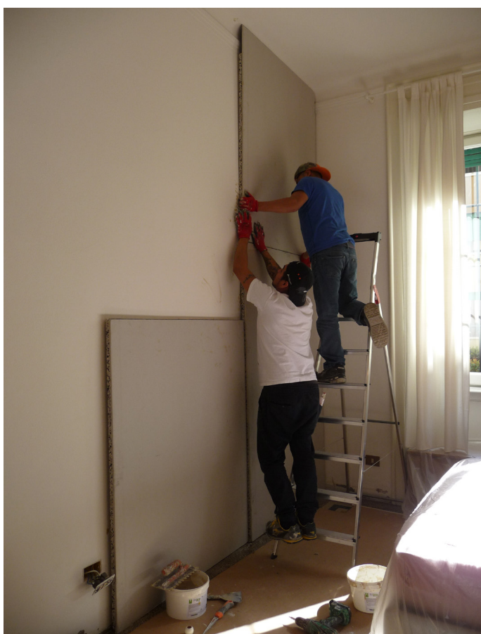
FASE 4 - Accostamento del primo strato di pannelli Habitat I alla parete esistente
